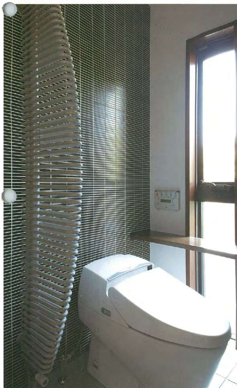
室温の変化をなくし、ヒートショックによる家庭内の事故を防止するにはトイレや浴室の暖房が効果的。 殺風景になりがちなトイレも、変化に富んだパネルヒーターでお洒落な空間に。
